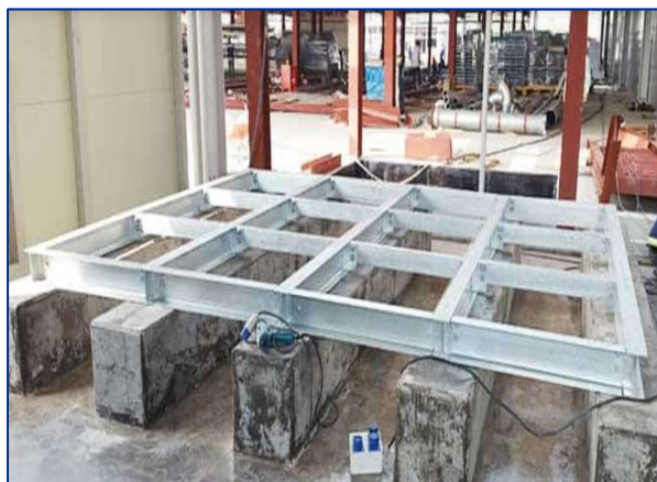
Hệ dầm thép đỡ/ Steel support beam system
